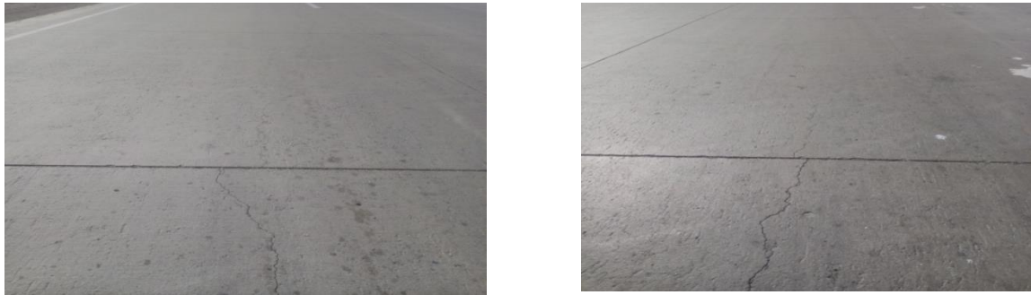
Рис.1. Автодорога А-380 «Гузюр-Бухара-Нукус-Бейнеу», продольная трещина вблизи поперечного шва.
